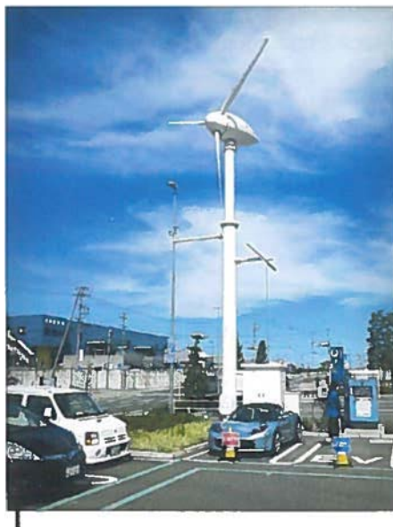
Obr. 4 – Dobíjecí stanice s větrnou mikroelektárnou
